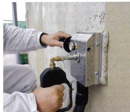
Durch den Einsatz einer Hochdruckkrake konnten Abbeizer und alte Farbe gründlich und sauber entfernt werden.
