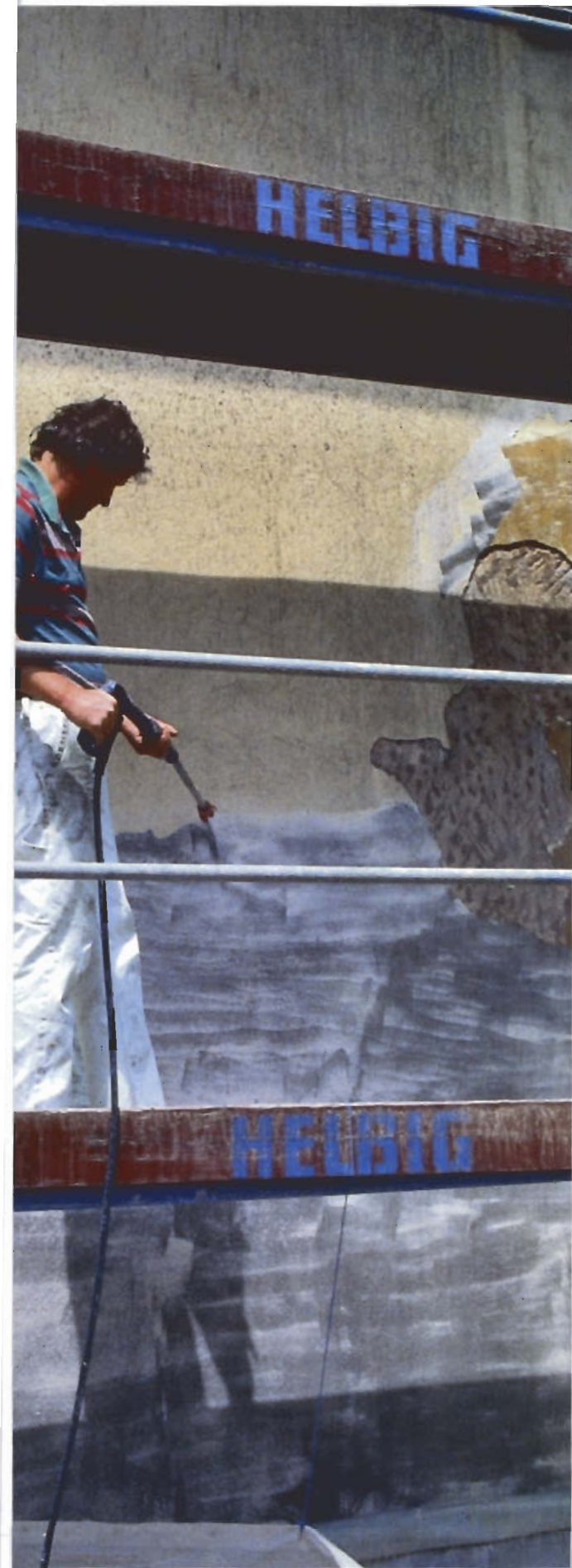
2 Entfernung des Abbeizers und der Farbschichten mit dem Heißwasserstrahl bei 80°C und 95 bar.
