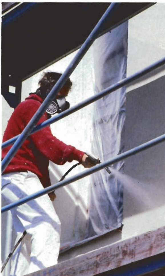
1 Das Aufbringen des Abbeizers im Airless-Verfahren spart Zeit und sorgt für gleichmäßigen Auftrag.
