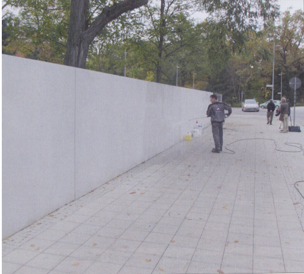
Die Beschmierung konnte ohne Beschädigung der Betonlasur vollständig entfernt werden. (Fotos: Scheidel)
